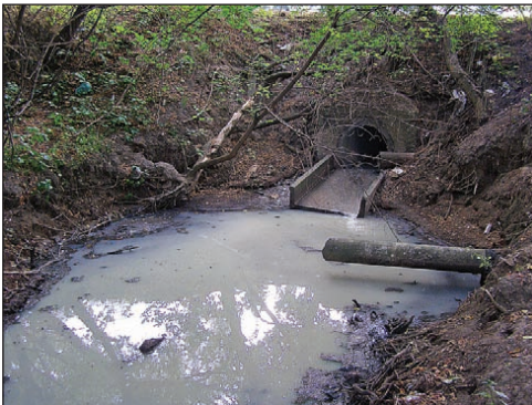
Рис. 5.44. Вигляд води, що витікає з колектора, що прокладений під вул. Мистецька, 25.09.2016 р.
